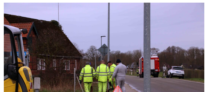
In Balow war am Freitag bei Baggerarbeiten eine Gasleitung beschädigt worden. Foto: Ralf Drefin
